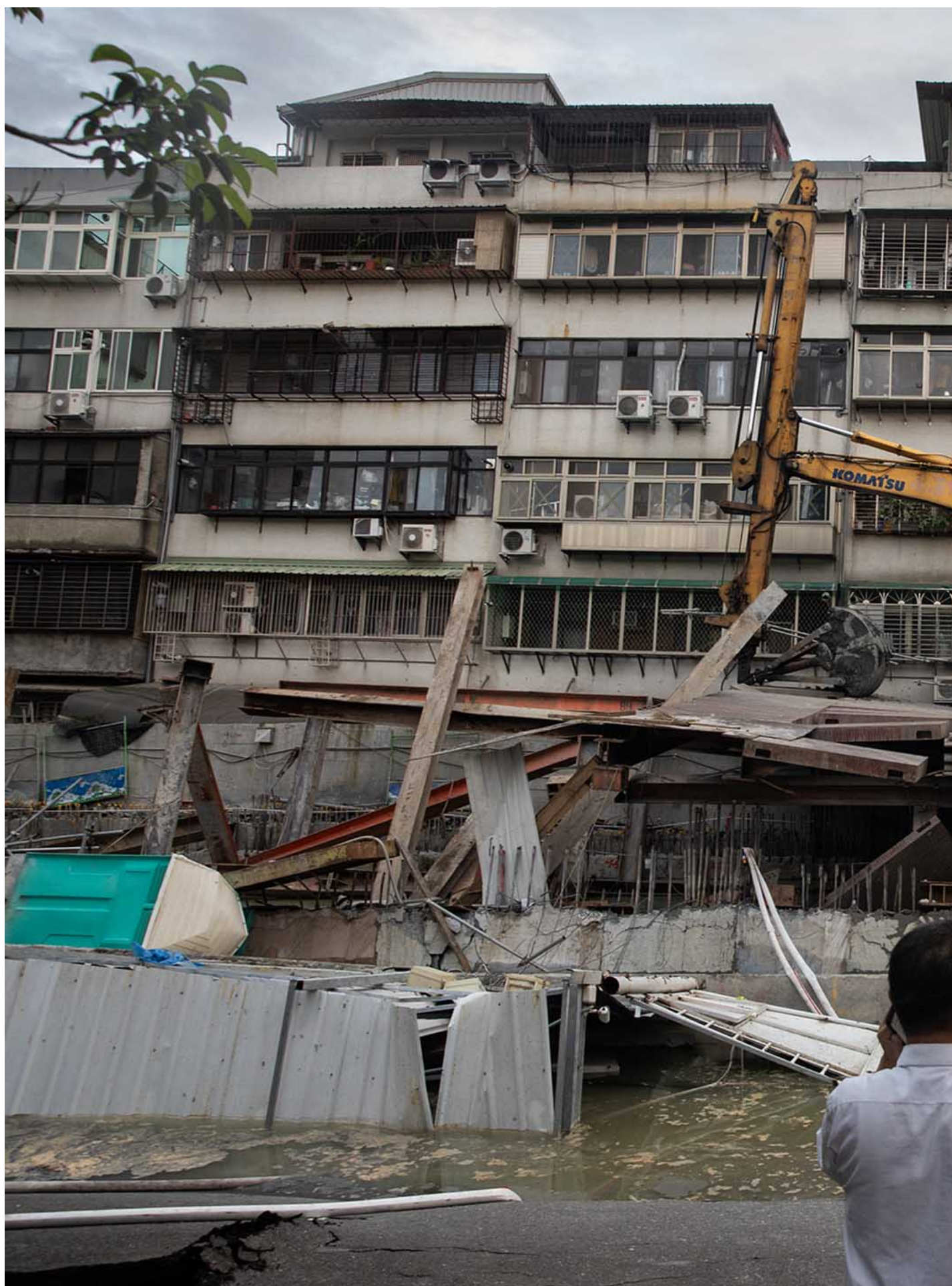
2023年9月8日，台北大直民宅塌陷。摄：陈焯焯/端传媒
