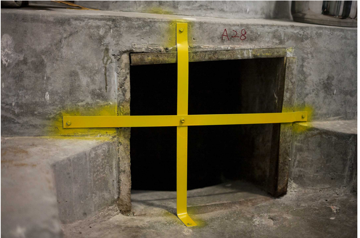
公共屋邨一个经修改后的槽口，加上了两根钢条令槽口变小。摄：林振东/端传媒
